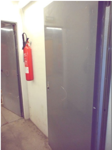
EXTINTOR SIN SEÑALIZAR
