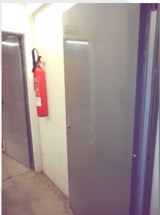
EXTINTOR SIN SEÑALIZAR
